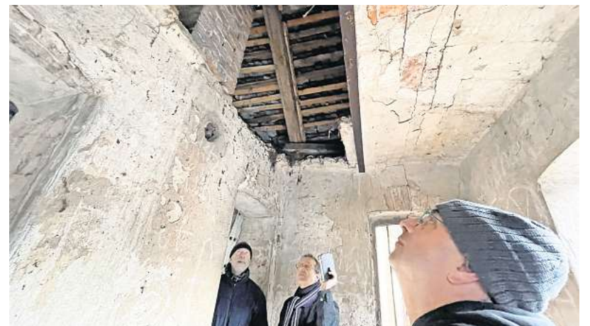
Thomas Enzmann, Lennart Hellberg und Berthold Schulze (von links) werfen einen Blick unter den Dachstuhl des ehemaligen Dom-Gefängnisses.
